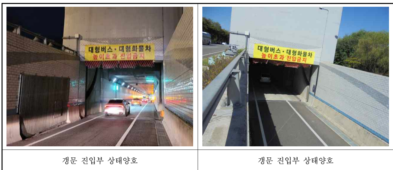
【사진 3.3.36】갯문 손상현황
