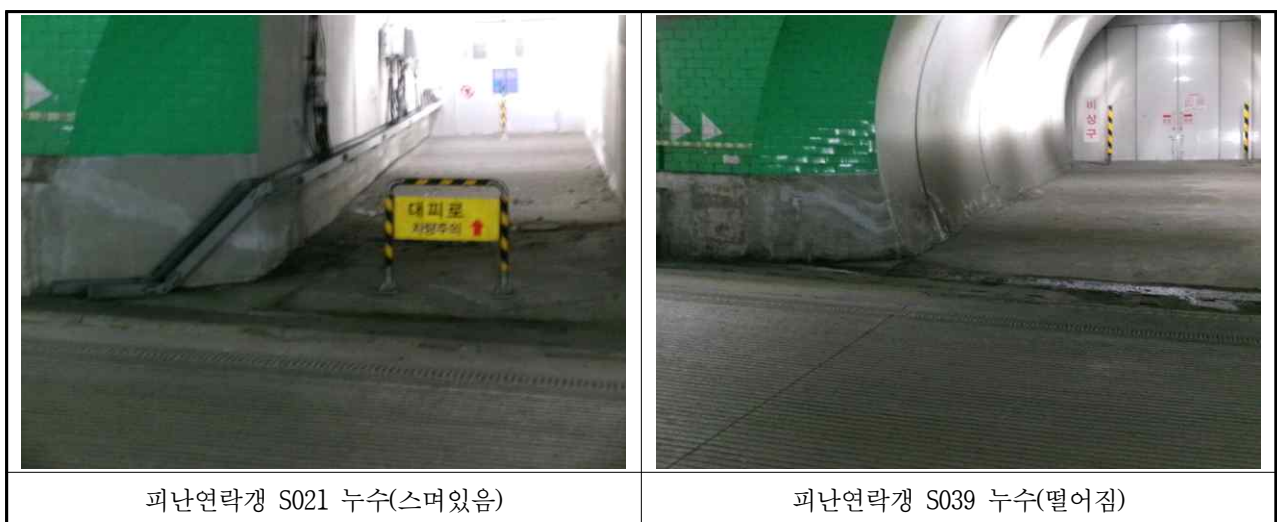
【사진 3.3.38】 피난연락갱 손상현황
