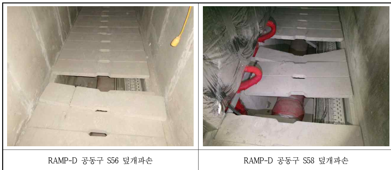
【사진 3.3.32】 공동구 손상현황(계속)
