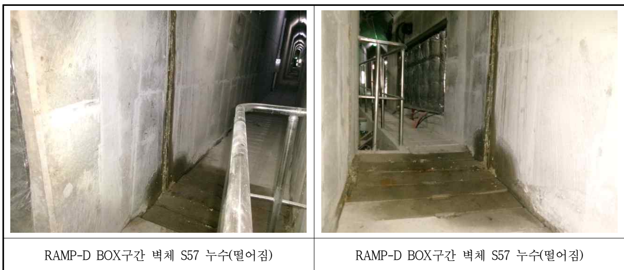
【사진 3.3.22】 BOX구간 벽체 손상현황
