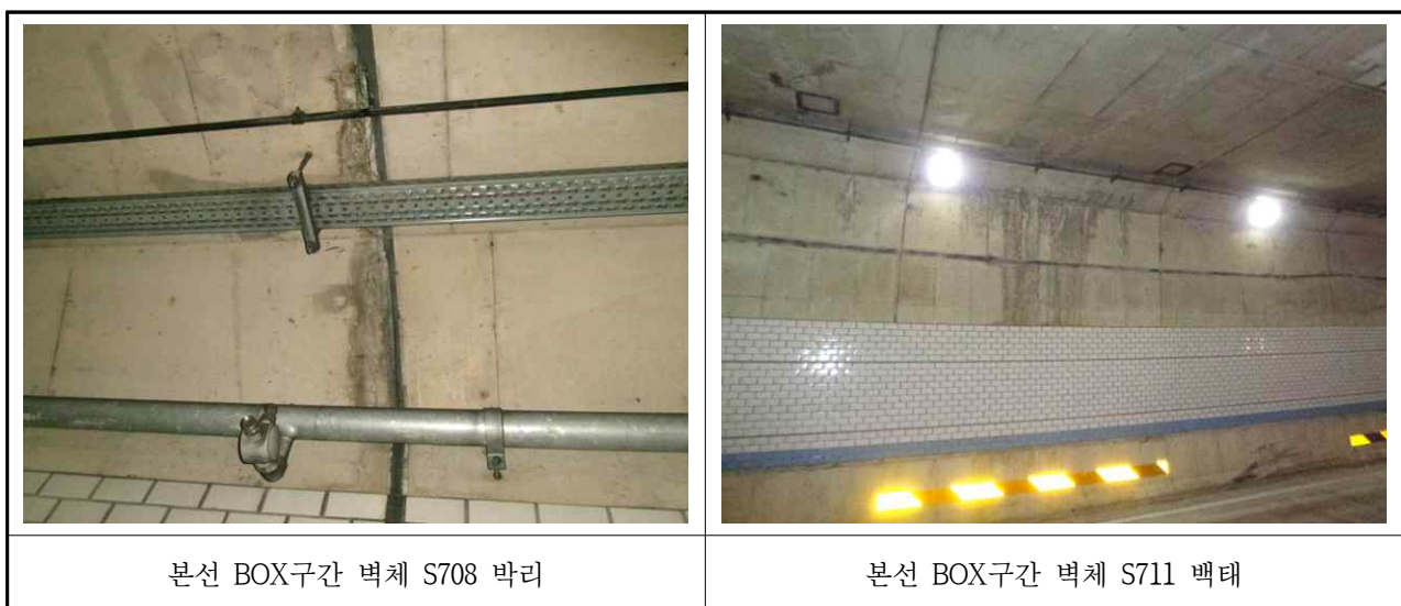
【사진 3.3.4】 BOX구간 벽체 손상현황
