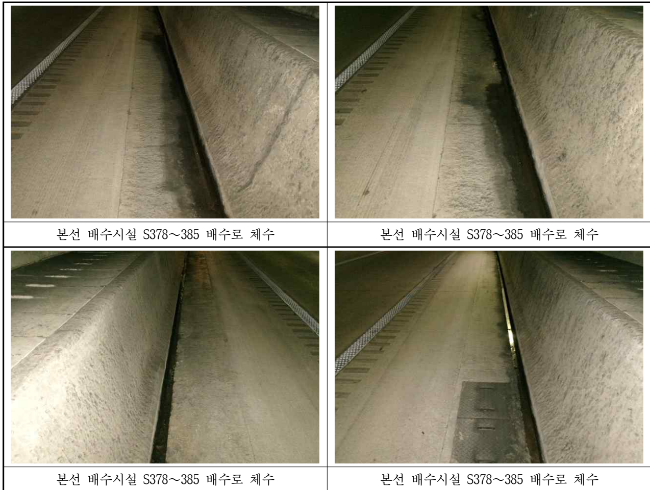
【사진 3.3.16】 배수시설 손상현황
