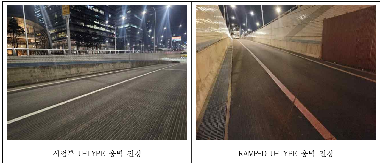
【사진 3.3.40】 U-TYPE 용벽 손상현황
