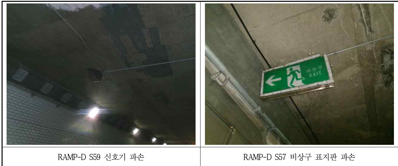
【사진 3.3.44】기타시설 손상현황
